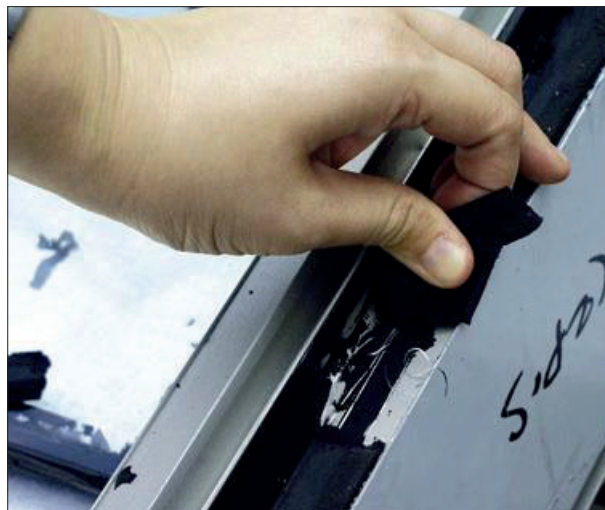
FIGURA 20 Adhesión incorrecta - test de desmontaje del acristalamiento negativo
